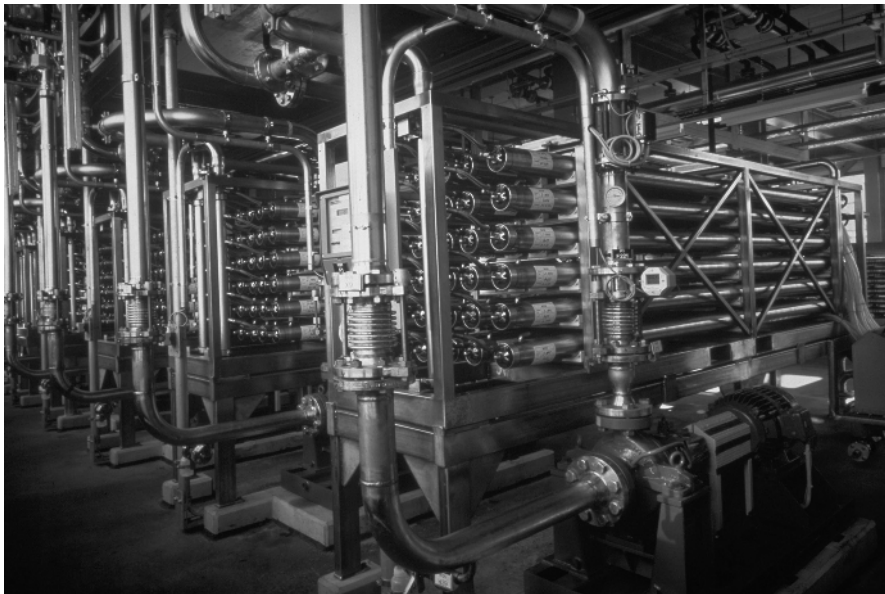
Abb. 9.3. Nanofiltrationsanlage zur Aufbereitung eines Abwassers aus der Textilproduktion, Lieferant: Membrane Products, Rehovot, Israel
